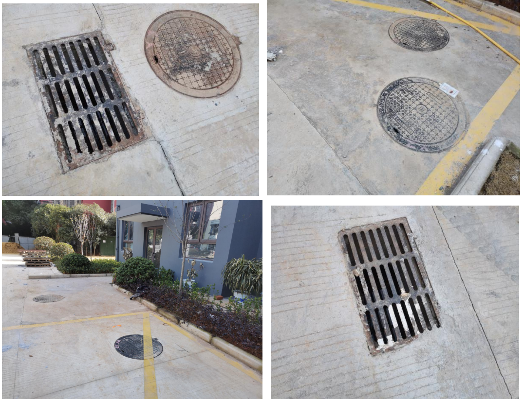
雨水管网、雨水口、雨水井（2023 年 12 月）
